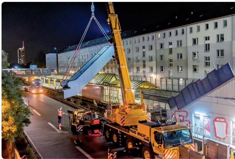
Eine der neuen 15 Meter langen und 12 Tonnen schweren Fahrtreppen wird nachts in Position gebracht. Schauplatz im August 2019 an der Haltestelle Savignystraße zwischen den gegenläufigen Autobahnspuren der A40 mitten in Essen. (Quelle: thyssenkrupp)
